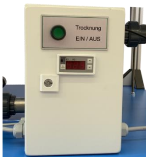
Armario de control de la unidad de secado
