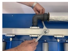
Ajuste en altura del conducto de aire
