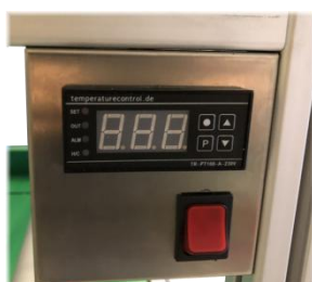
Armario de control de la unidad de secado
