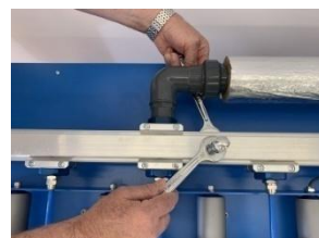
Ajuste en altura del conducto de aire
